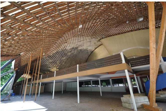
24 sichtbare provisorische Unterstützung des Haupttragwerks
