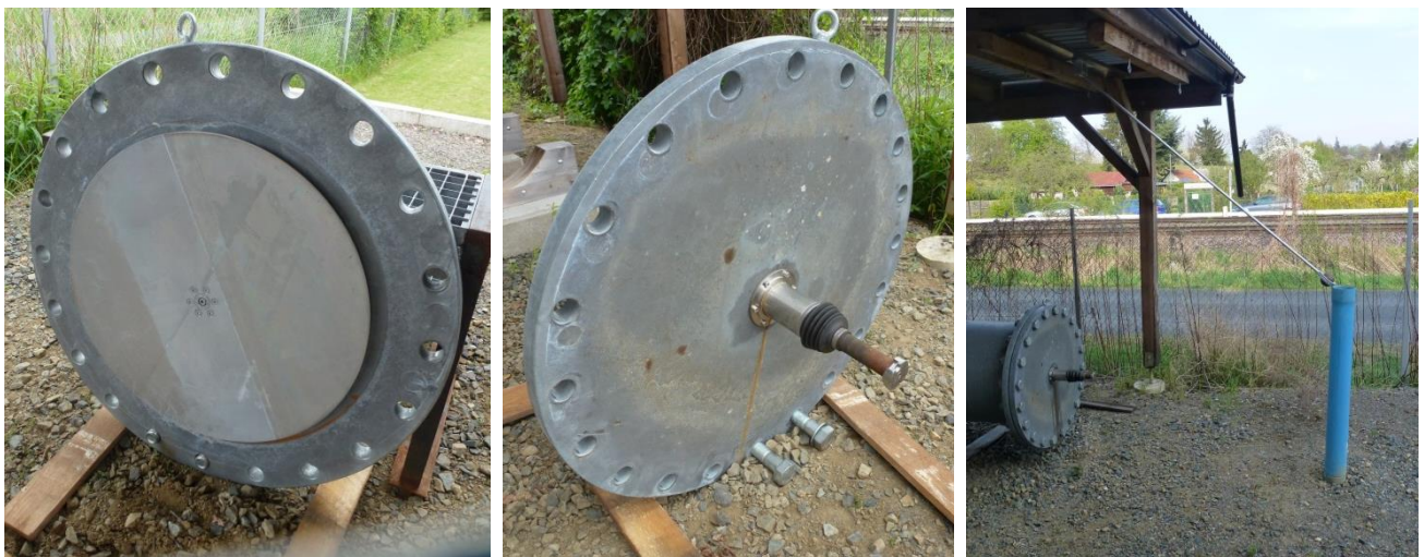
Abbildung 19: Impulseinleitung am Druckrohr
