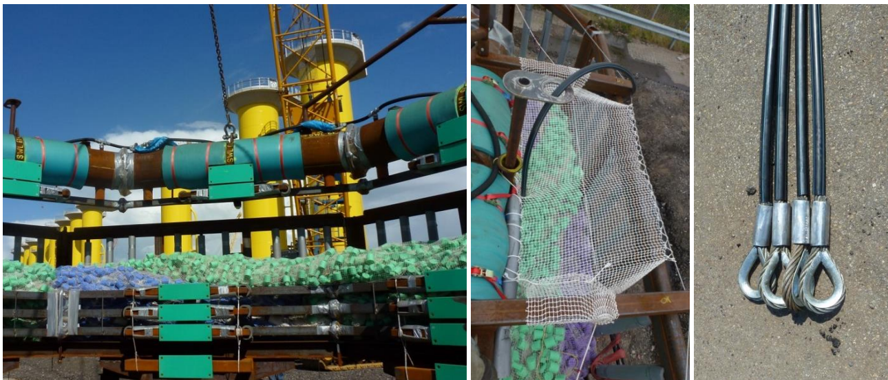
Abbildung 41: HSD-System nach der Reparatur: Ballastring und Schwimmring mit angeschweißten Distanzringen (links), Führung für Tragseile (Mitte), in Kunststoffrohr eingezogene Tragseile (rechts)
