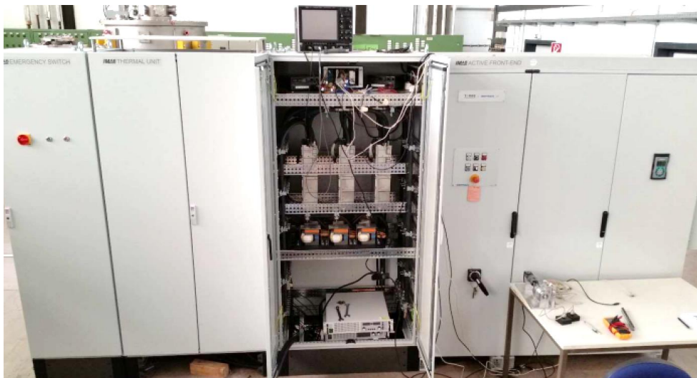
Schaltanlage enersphere – aufgebaut in der IMAB E-Werkstatt
